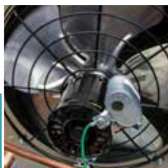
Motor y ventilador
