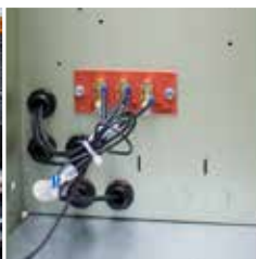
Tablilla de conexiones
